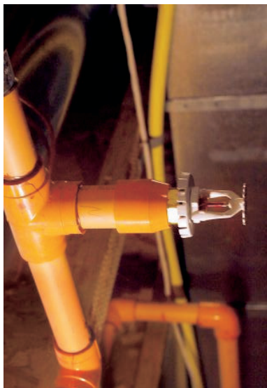
Impianto a pioggia (sprinkler)
